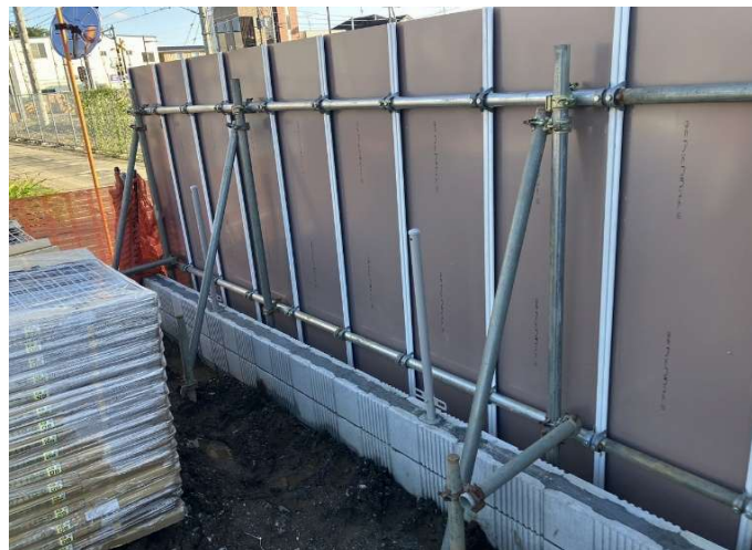
ブロック 跨ぎ施工 OK
