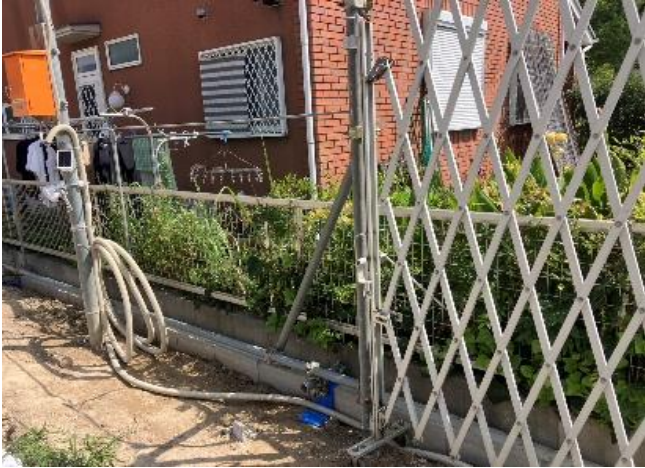
ゲート部状況（補強不足）
