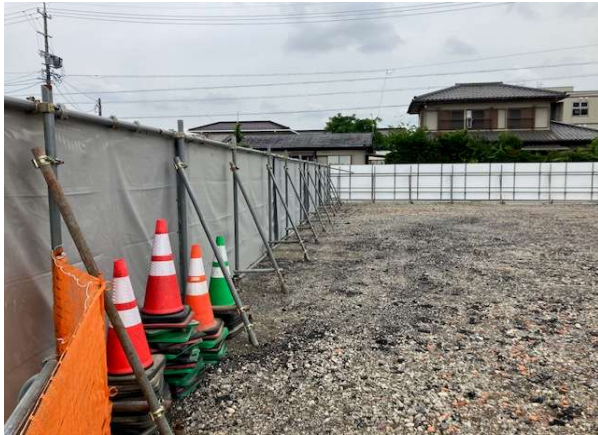
① 単管SF骨組み 良好
