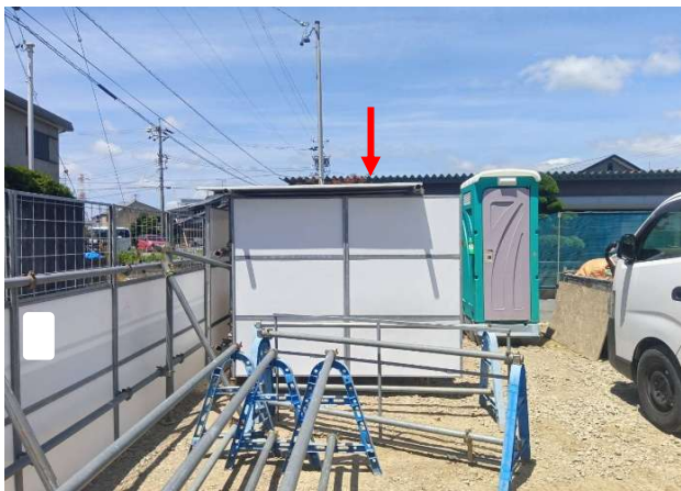
⑤ 水切りの屋根勾配がついていない 部材の準備不足
