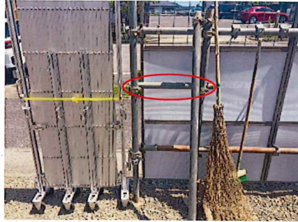
ゲートが倒れないよう 補強されておりました
