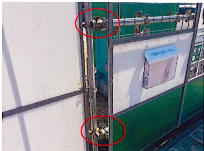
単管端部養生不足
