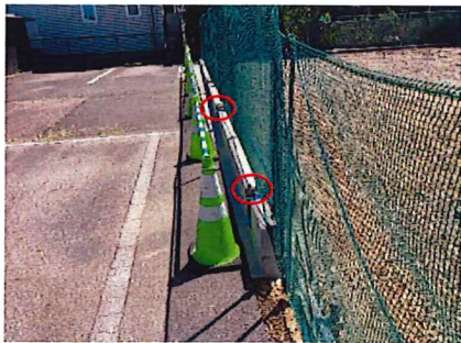
クランプ養生不足
