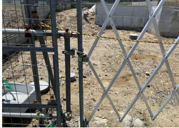
② ゲート周りのクランプ養生不足
