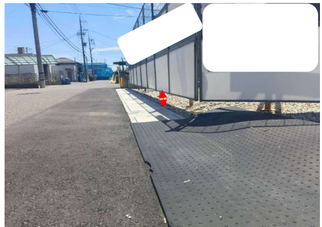
⑥ フェンス下の隙間が20cm以上ある 段付けし下げる等して隙間を無くす
