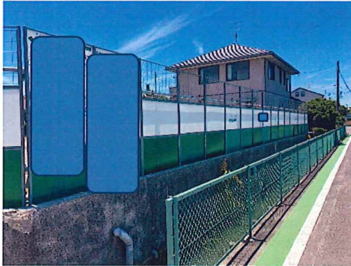
現場正面 オリジナルフェンス状況 若干の傾きあり、パトロール隊員にて修正済み
