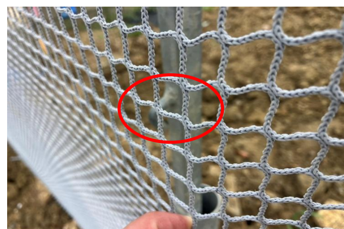
ネットフェンスフック止め忘れ
