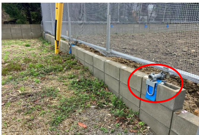
挟み込み状況 クランプカバー不足
