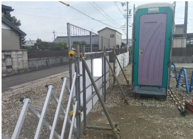
⑤ パネルフェンス背面良好
