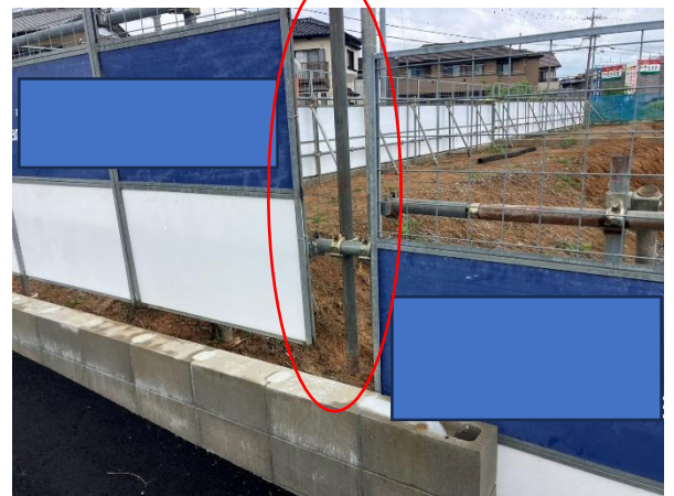
施工面の距離が材料の寸法と合わず できてしまった隙間 こちらも施工方法検討していきます
