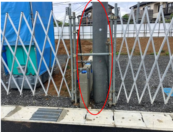
障害物の為 隙間ができた状況 少しでも隙間がなくなるよう 施工方法の検討していきます
