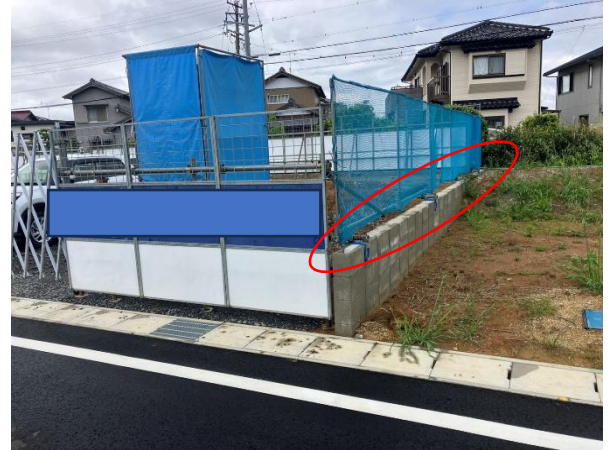
隣地様との取り合い状況 クランプの養生があるとよかった
