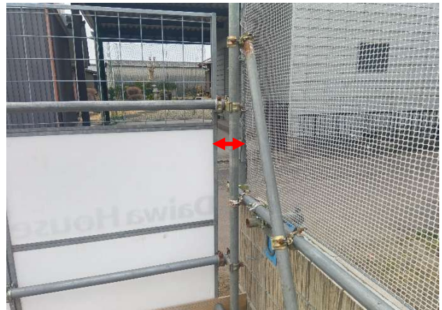
④ フェンス取り合い部分の隙間 が大きい
