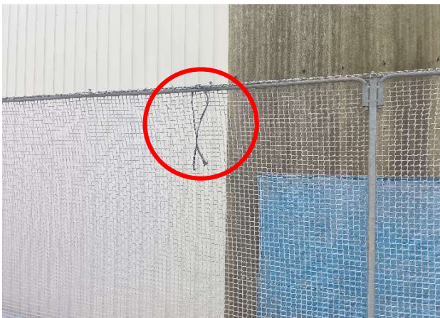
⑤ 不要なPPロープが付いたままに なっている
